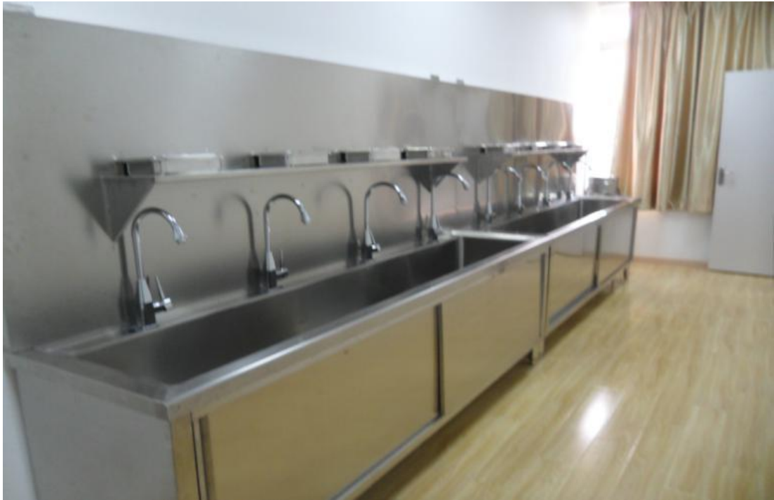
图 8 手术室洗手池
